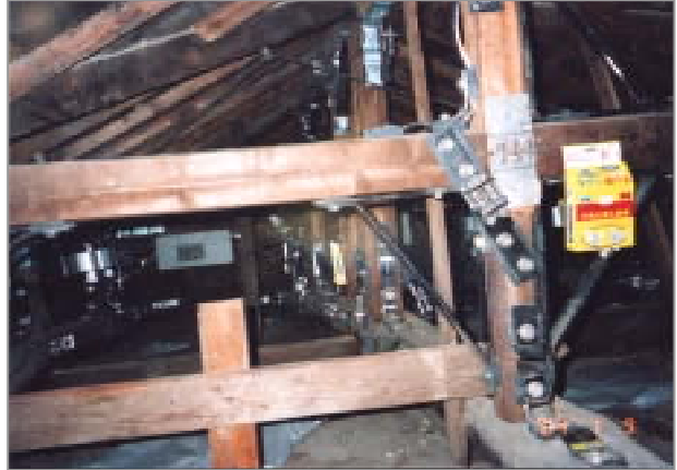
屋根裏の金物補強工事などにより、総額 2,500 万円の被害
